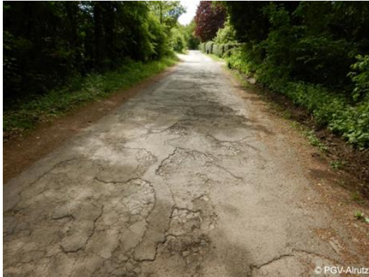
Auf der Filzer Kupp Belagsschäden
